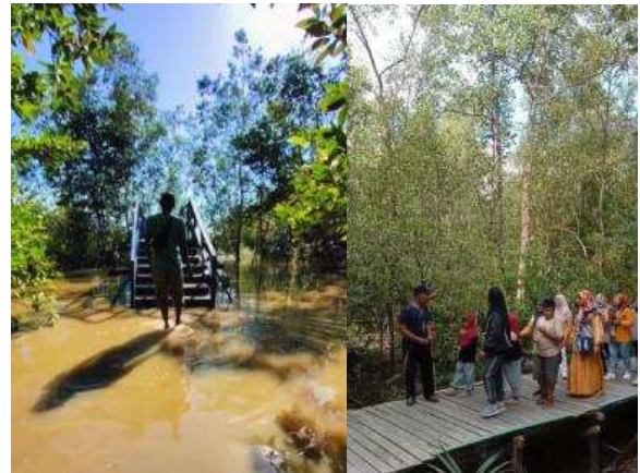
Gambar 1. Kondisi Boardwalk Saat Pasang Tinggi dan Pendampingan Wisata Mangrove
