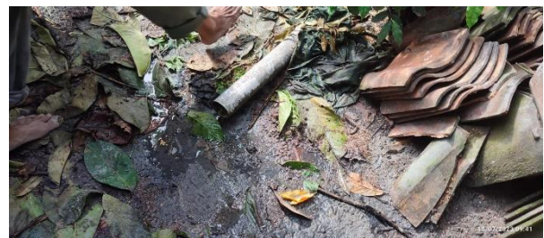
Gambar 8. Kondisi Air Limbah sebelum dilakukan Pembuatan Saluran Pembuangan Air Limbah rumah tangga (SPAL)
